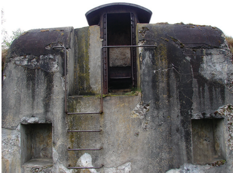
Ил. 6. Брест-Литовская крепость. Форт V. Казематированный траверс с наблюдательным постом системы Аренса. Современное фото
